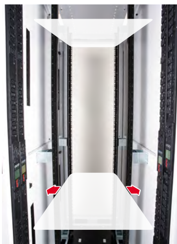
収納・配線スペースが拡大
