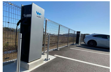
▲ 駐車場に設置している EV 充電器「WayEV」
