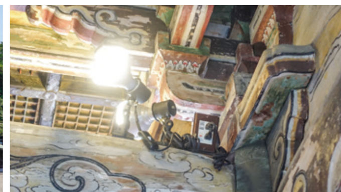
設置したプレトラックコンセント(高台寺)
