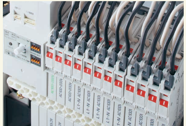
業界最薄のブレーカを搭載した分電盤の内部
