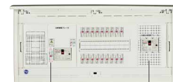
太陽電池側ブレーカ (逆接続可能タイプ)
