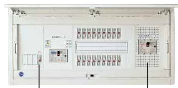
電気温水器(エコキュート) 太陽電池側ブレーカ(1次送り) (逆接続可能タイプ)
