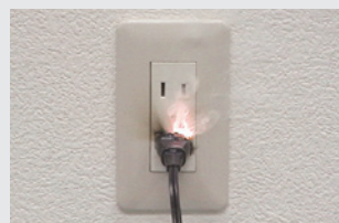
トラッキング火災発生の様子
